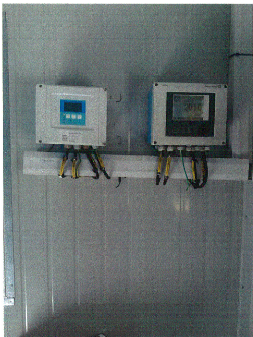
COD、废水流量在线检测仪
