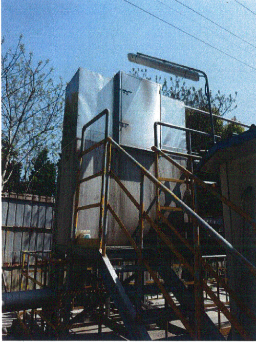
废水总排口（不锈钢水池）
