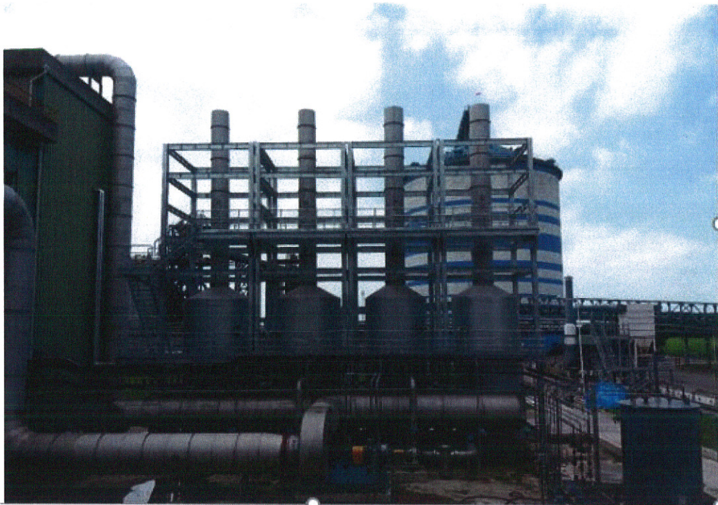
调质和膨化工段豆粕异味气味技改装置
