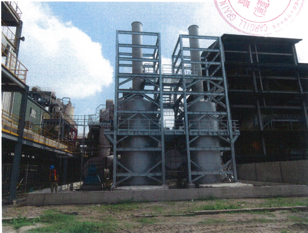
浸出工段豆粕异味气味技改装置
