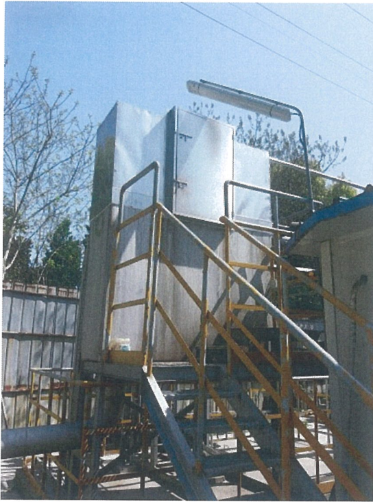
废水总排口（不锈钢水池）
