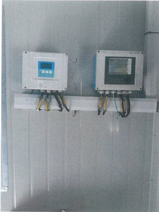
COD、废水流量在线检测仪
