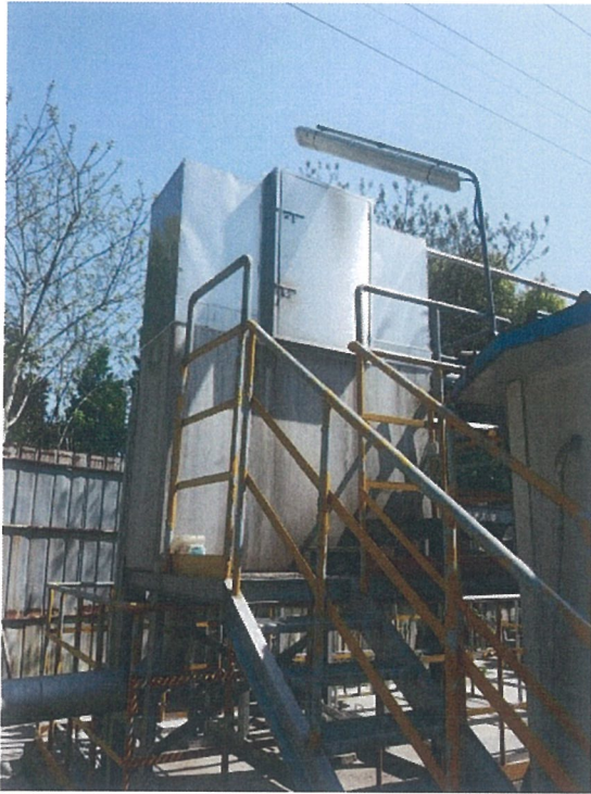
废水总排口（不锈钢水池）
