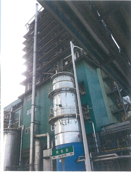
高压锅炉排气筒
