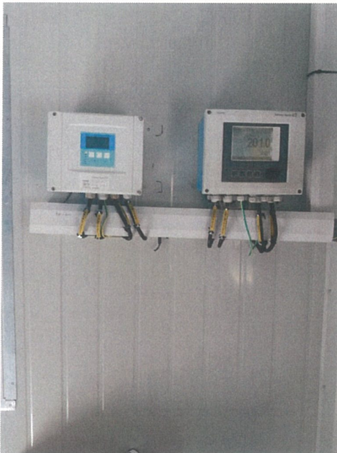
COD、废水流量在线检测仪
