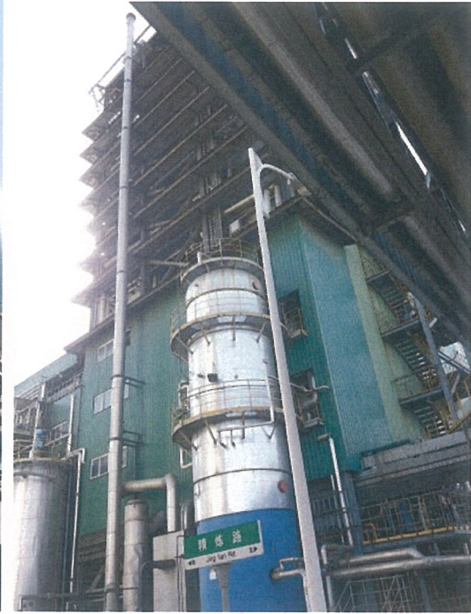
高压锅炉排气筒
