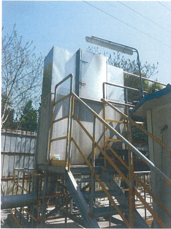
废水总排口（不锈钢水池）
