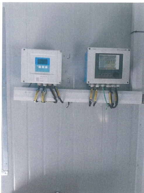
COD、废水流量在线检测仪
