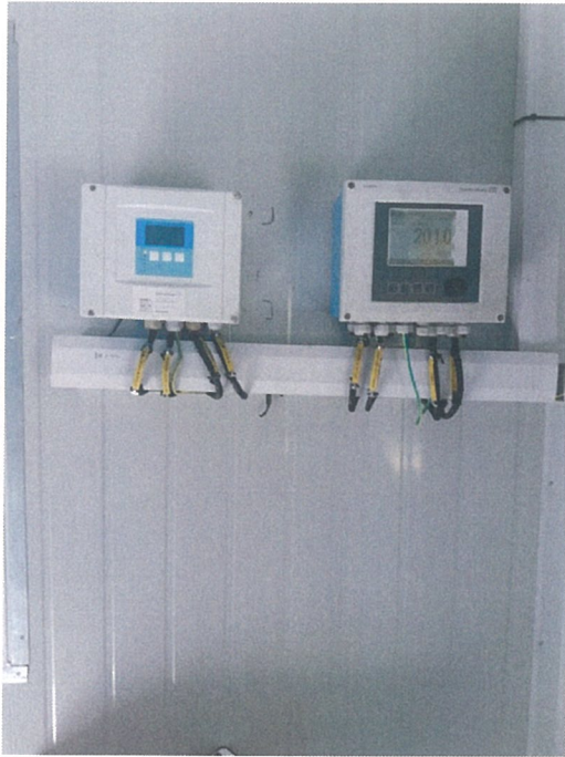
COD、废水流量在线检测仪
