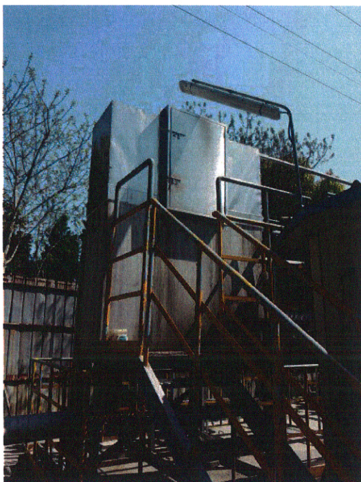
废水总排口（不锈钢水池）
